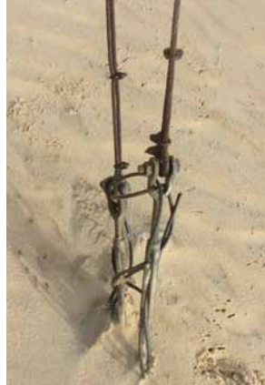
Fig. 47: Rusty guy wire
