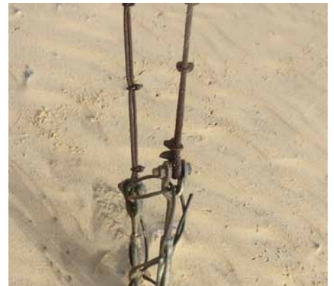
Fig. 65: Rusted guy wire
